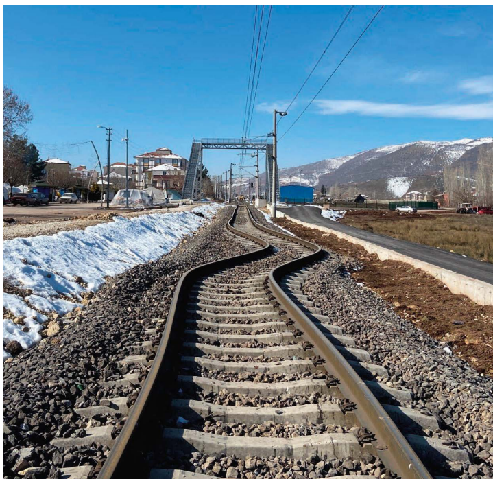
Tor kolejowy na południu Turcji zdeformowany podczas silnego trzęsienia ziemi w lutym 2023 r. W tym miejscu ziemia przesunęła się w poziomie o ponad 2 m.
