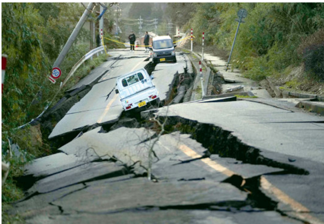
Zniszczenia w pobliżu miasta Noto na półwyspie o tej samej nazwie po trzęsieniu ziemi, które nawiedziło Japonię 1 stycznia 2024 r.
