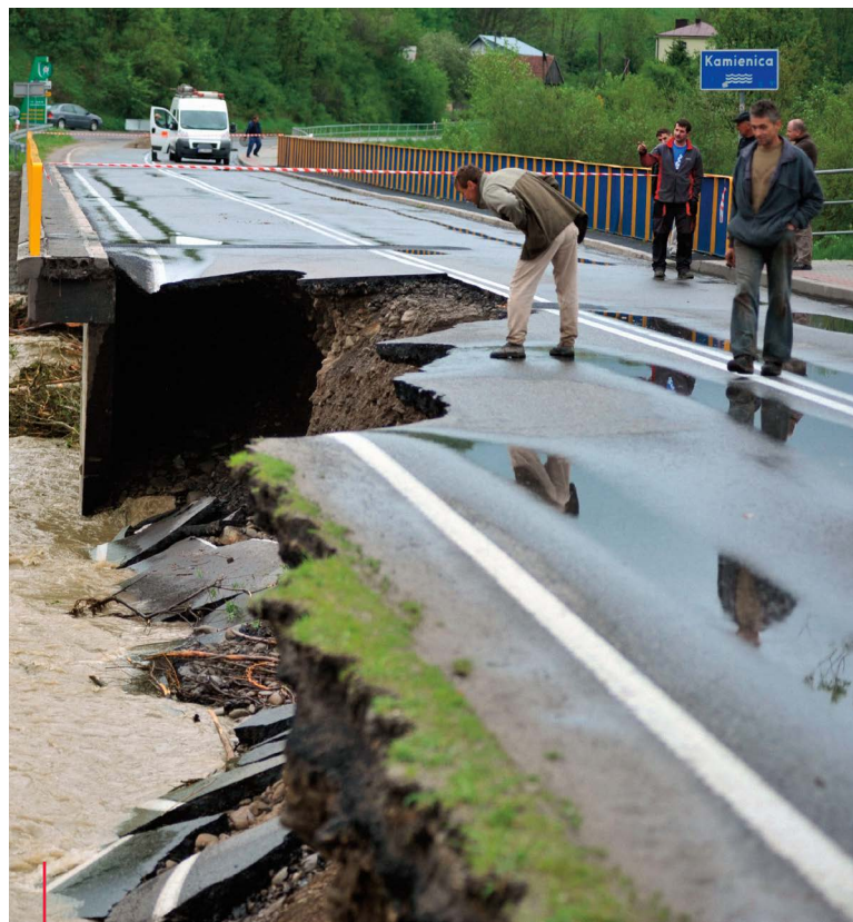
Województwo małopolskie – zniszczony most w Kamienicy
