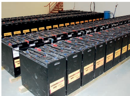
Rysunek 2.1. Zestaw akumulatorów o łącznej mocy 60 kW i stałym napięciu wyjściowym 480 V zainstalowany w korporacyjnym centrum obliczeniowym jako uzupełniające źródło zasilania. (Zgodę na publikację zdjęcia wydała firma Hybridne Power Systems Canada Inc. będąca właścicielem praw autorskich. Dalsza reprodukcja wymaga dodatkowej zgody ze strony wymienionej firmy)
