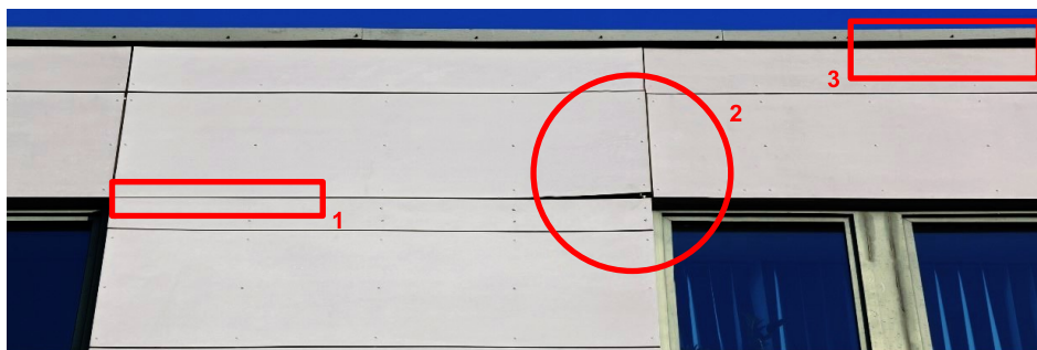
Fot. 1. Typowe uszkodzenia elewacji wentylowanej wykryte podczas kontroli okresowej 1 – zanik spoiny pomiędzy okładzinami, 2 – oderwanie się okładziny od rusztu, 3 – uszkodzenie obróbek elewacyjnych na attyce
